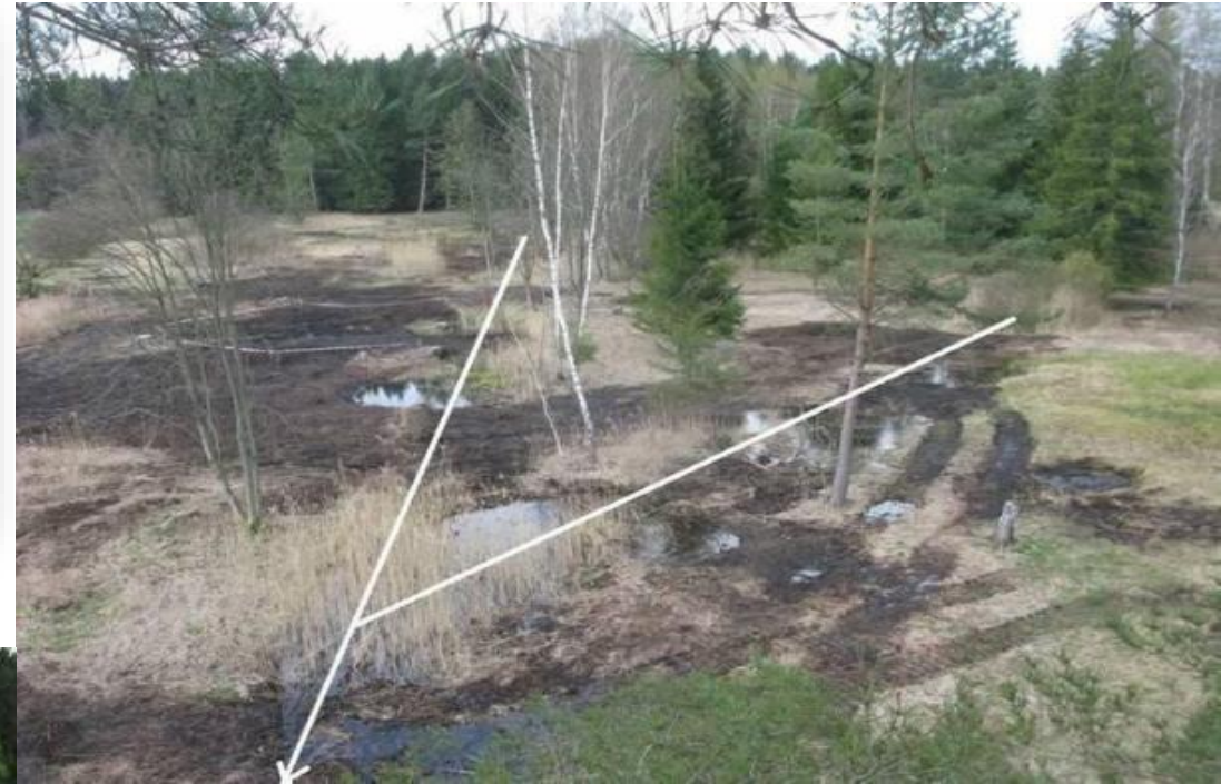
Obr. 8 Pohľad na plochu bezprostredne po dokončení revitalizácie. Šípkami je označené pôvodné vedenie odvodňovacích priekop. V rámci revitalizácie boli vytvorené kaskády malých jazierok a zavodnených depresí (foto Filip Lysák).
